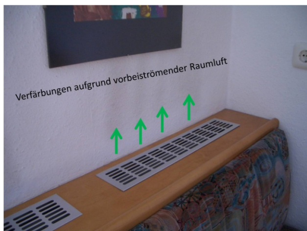
Bild 6: Verfärbung aufgrund vorbei strömender Raumluft (Heizkörper)
